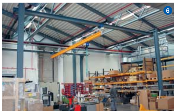
6: Puentes grúa ligeros monorraíles ABUS EHB-I
